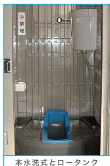
本水洗式とロータンク
